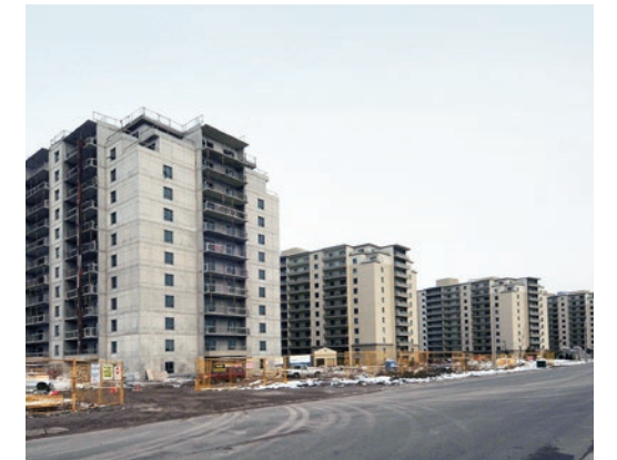
Un complexe immobilier résidentiel en construction au 161 Fallowfield, Kitchener, Ontario en train de se faire isoler et sceller avec de l'insulthane Extreme.
