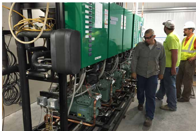
低温冷凍ラックシステムの最終調整をするゼロゾーン、SCR、およびコボーンズ社設備チーム
